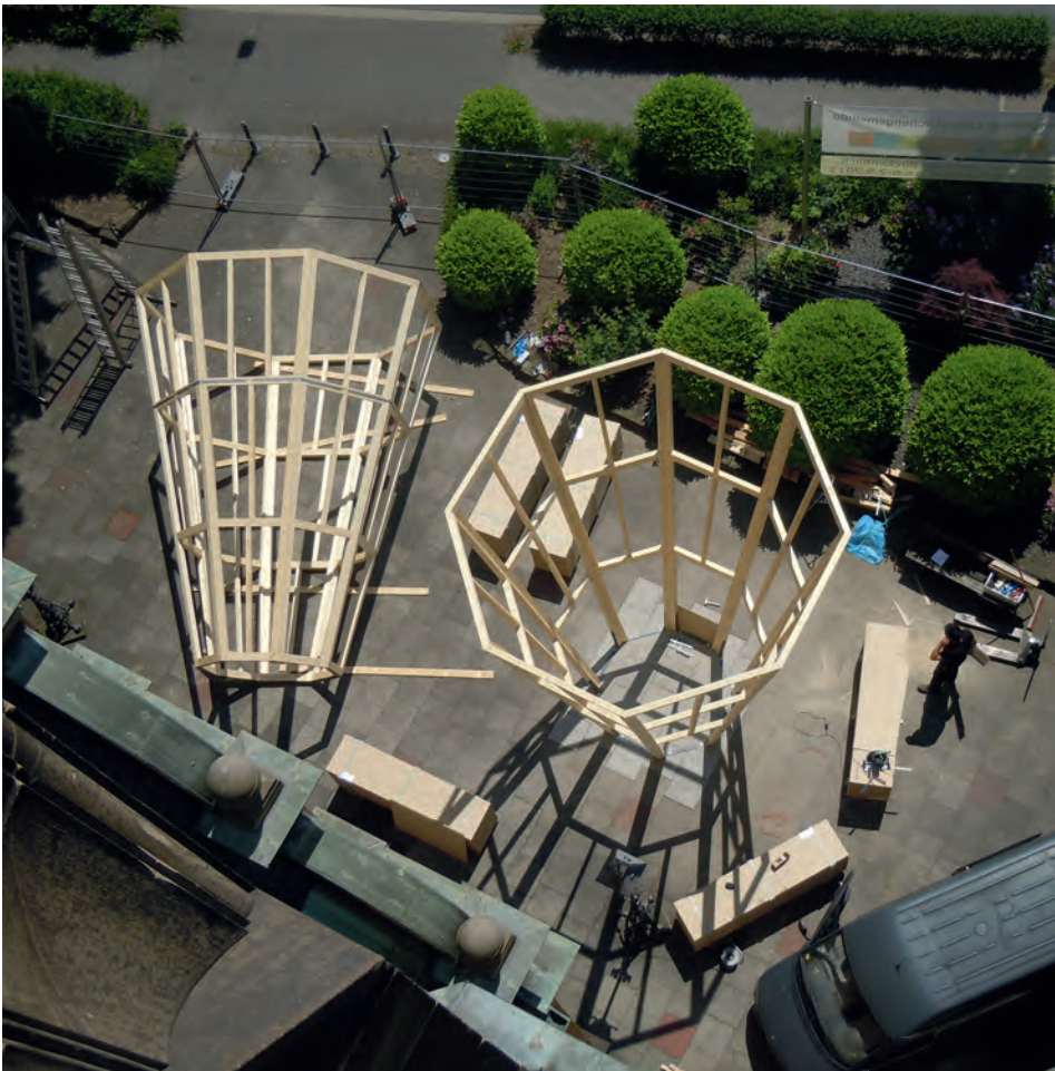
Aufbau der Installation Enjoy the silence auf dem Vorplatz der Lutherkirche. Verschraubung der Innenkonstruktionen und Verankerung auf dem Betonfundament
